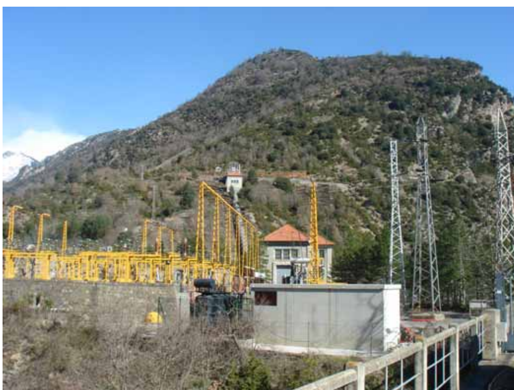
Parque de transformación y central del salto de Argoné
