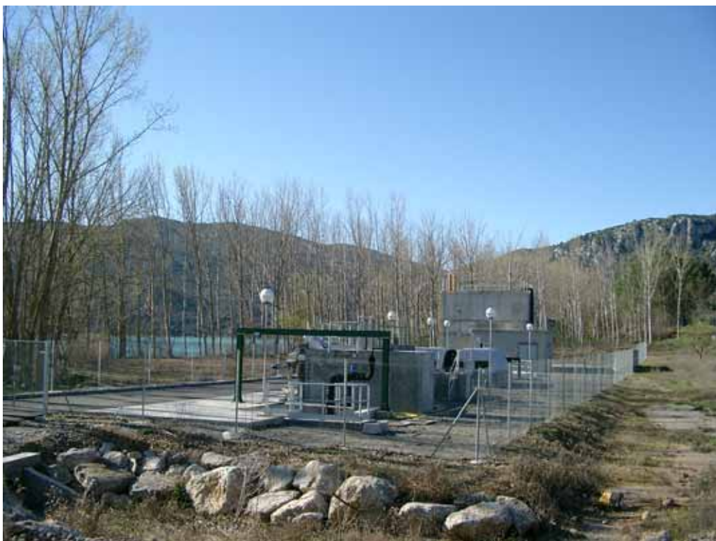
Depuradora de La Puebla de Castro
