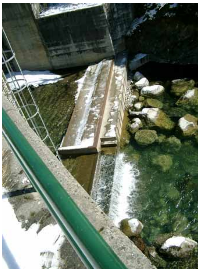
Estación de aforos EA-145
