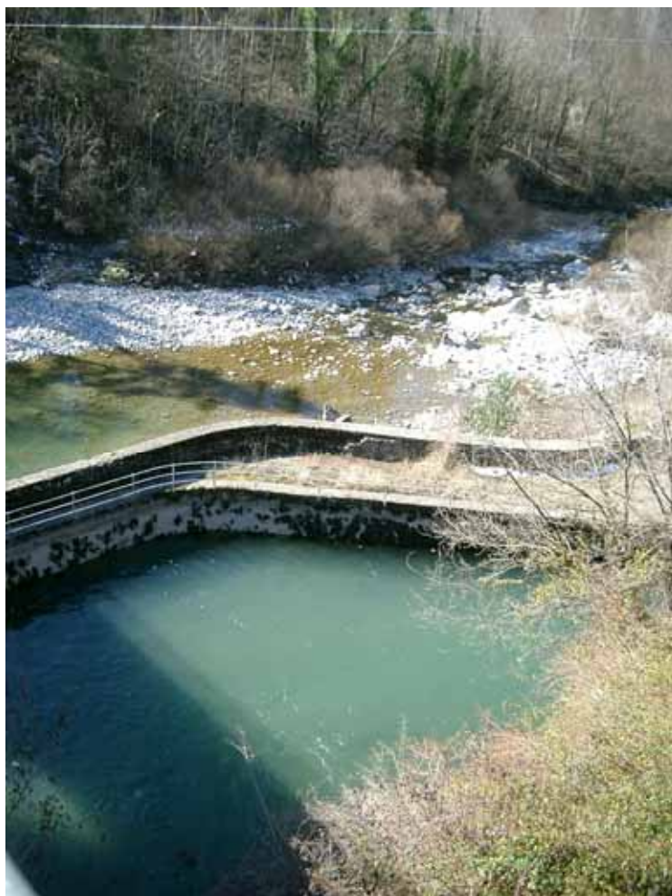
Cámara de decantación o arenero de la toma del salto de Argoné
