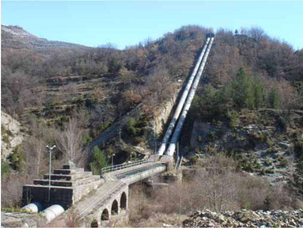
Tubería forzada del salto hidroeléctrico de El Run
