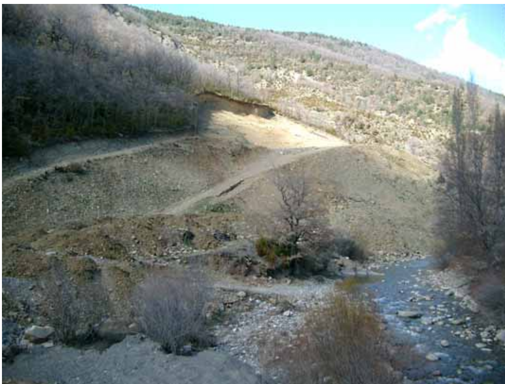
Margen derecha del Isábena cubierta por derrubios de la carretera
