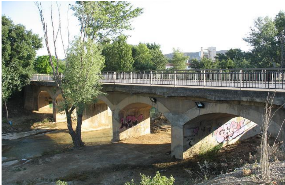
Figura 26-5. Puente sobre el río Flumen en la localidad de Tierz. Ejemplo de alteración del lecho.
