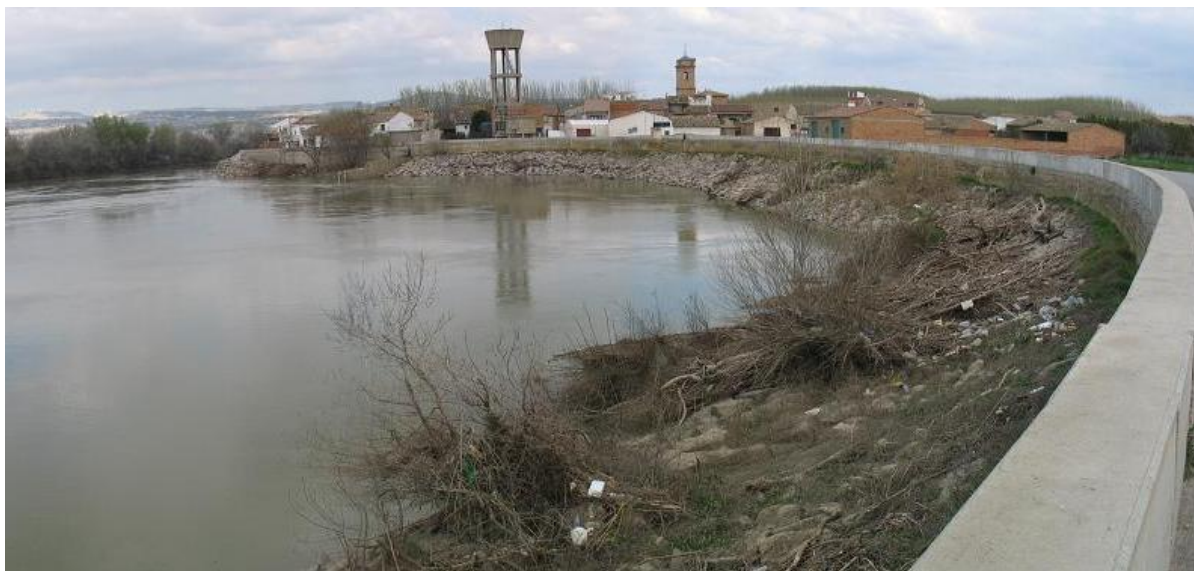
Figura 52-75. Escolleras y gaviones en Cabañas de Ebro.
